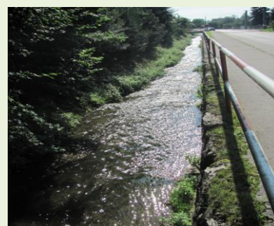
Potok zregulovaný, s betónovým dnom, kde voda odtečie rýchlo ako po šmyklavke.
